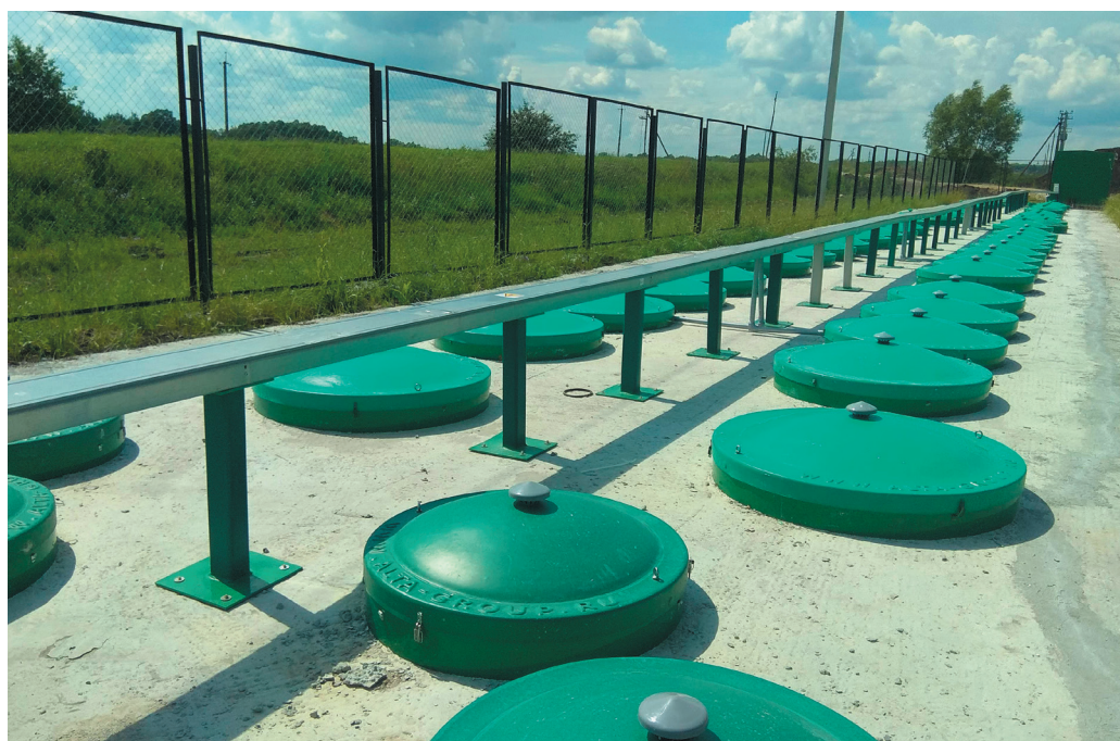
Рис. 3. Коммунальные очистные сооружения поселка (п. Сапожок, Рязанская обл., хозяйственно-бытовой сток – 200 м 3 /сут)
